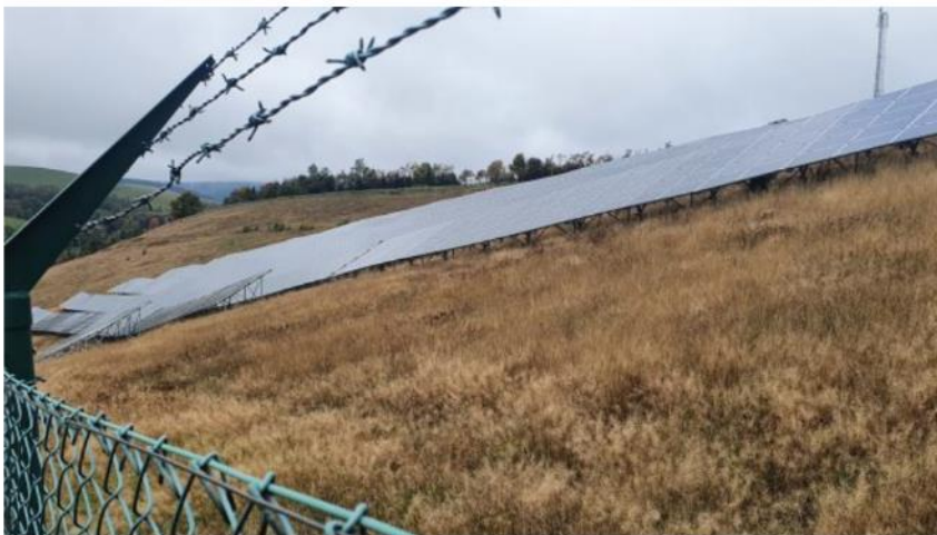
Fotovoltaická elektrárna na Moldavě | Foto: Artur Janoušek | Zdroj: Český rozhlas
